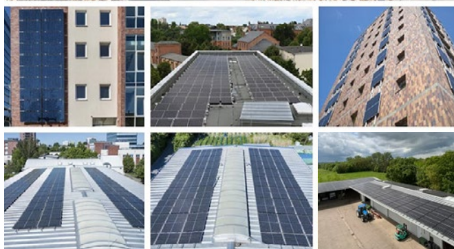
Die installierten PV-Anlagen an den UFZ-Standorten. Fotos: UFZ
