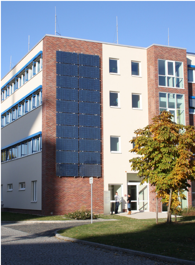
Photovoltaikanlage am Gebäude 7.1 am Standort Leipzig, Foto: UFZ
